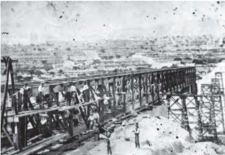
Construcció del viaducte del Quisi en fase de llançament. Té una longitud de 172 metres, una altura de 33,5 metres. Fou dissenyat Per J. Carbonell el 1911 i construït per la Societat Travaux Públics. Foto Col·lecció Vicente Ferrer.
