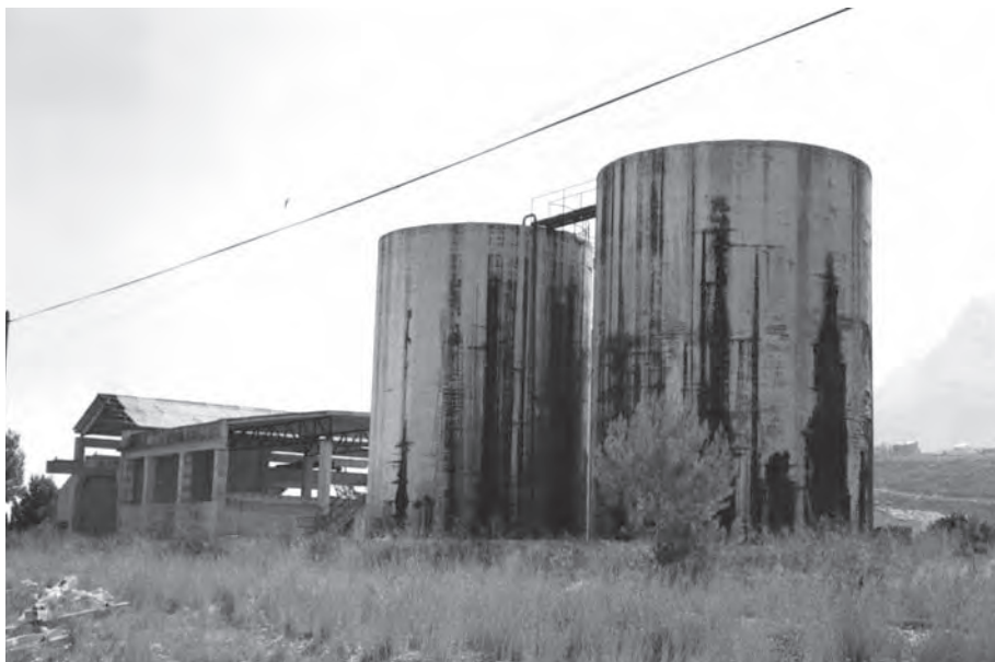
Conjunt de cisternes amb les instal·lacions annexes on es magatzemava el fuel-oil per al funcionament del forn de la fàbrica. Foto Vicente Ferrer.
