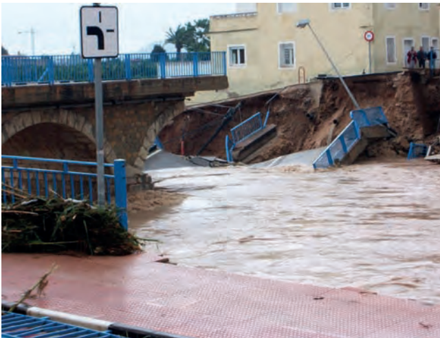
Trencament de l'antic pont de Beniarbeig (Font: Plataforma Ciutadana riu Girona).
